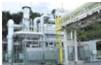
蓄熱燃焼式脱臭処理装置(二本松事業場)
